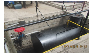
Tanque de Lodos
