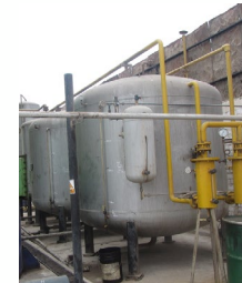
Tanques de almacenamiento
