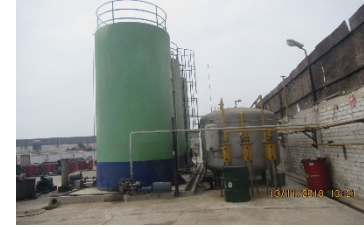
Tanques de recepción
