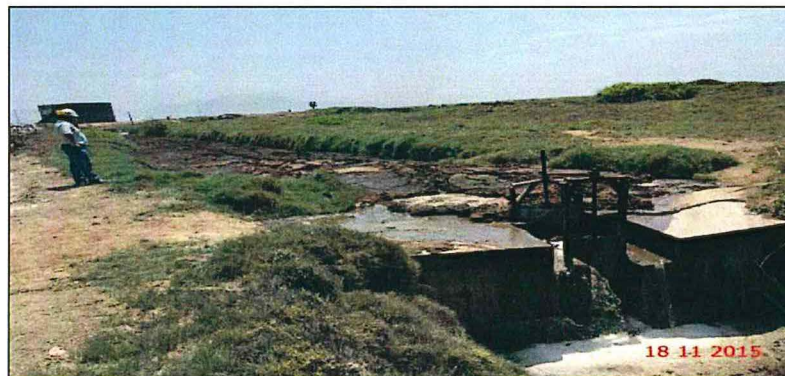
Fotografía 12: Tramo del “canal principal” colmatado con agua residual industrial con presencia de fibras de bagazo de caña en su superficie, que discurren sobre la compuerta metálica hacia el otro lado de ésta con dirección hacia la playa El Charco.
