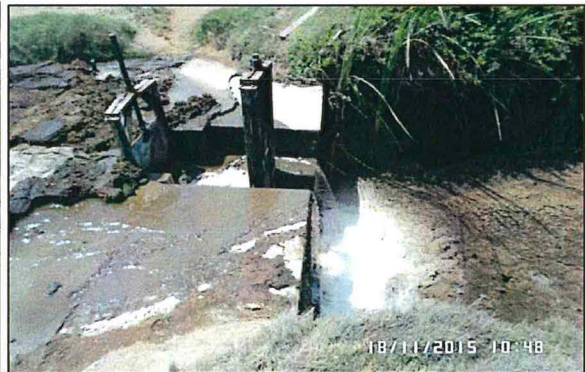
Fotografía 11: Agua residual industrial de la planta discurriendo sobre la compuerta metálica, la cual se encuentra cerrada.
