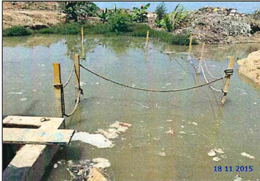
Fotografía 10: Poza de bombeo con agua residual industrial que sobrepasa su capacidad. Las estacas de madera bordean el perímetro de la poza, apreciándose en la fotografía que se encuentra cubierto por agua residual industrial.
