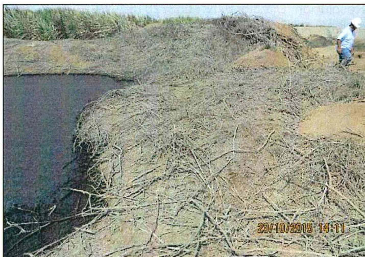
Foto N° 15: Se observa un sector de la poza de evaporación y sedimentación N° 1, el dique de contención cubierto por restos de maleza, cercano a los campos de cultivo de caña de azúcar TRUPAL 1.
