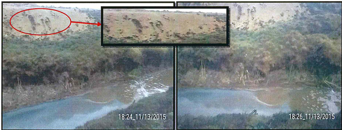
Fotografía 25: Presencia de lignatos de sodio en la cara lateral del talud de la Poza de Licor Negro N° 04, al costado izquierdo del "canal principal".
