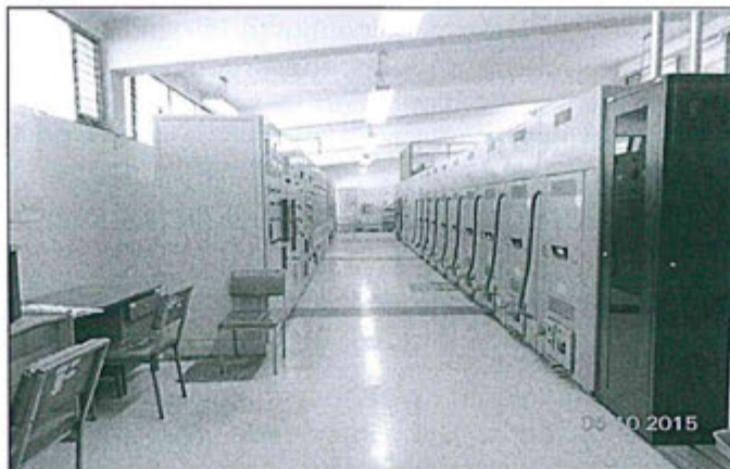
Sala de control de SET Bellavista
