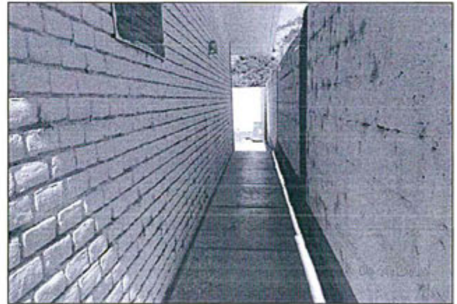
Pasadizos Externos de La Sub Estación Bellavista - Puno
