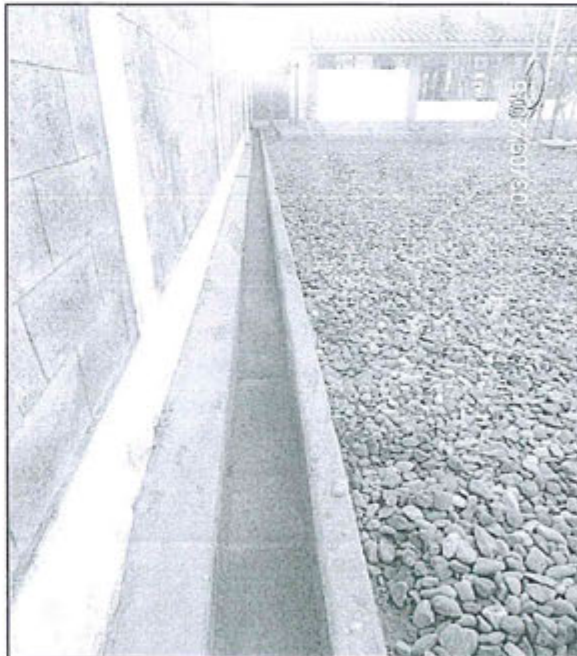
CANALETAS PERIMETRO INTERIOR DE LA – SET ILAVE
