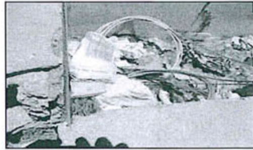
Vistas 2: Poza con cables eléctricos.
