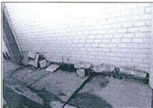
Vistas 4: en la vereda se encuentran equipos, desechos juntos
