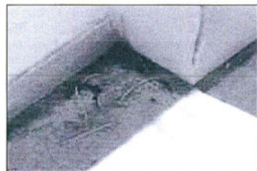
Vistas 4: Retazos de cable en el piso
