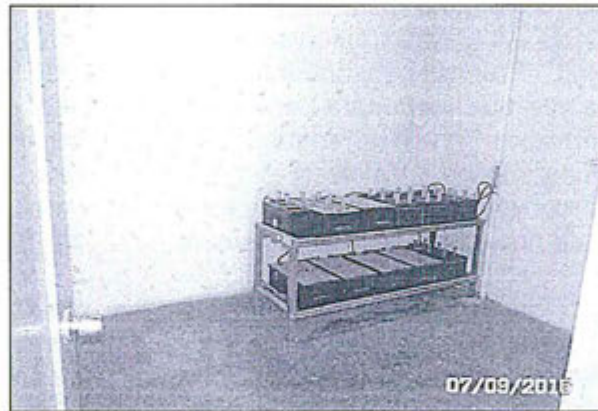
SALA DE BATERÍAS – SET BELLAVISTA
