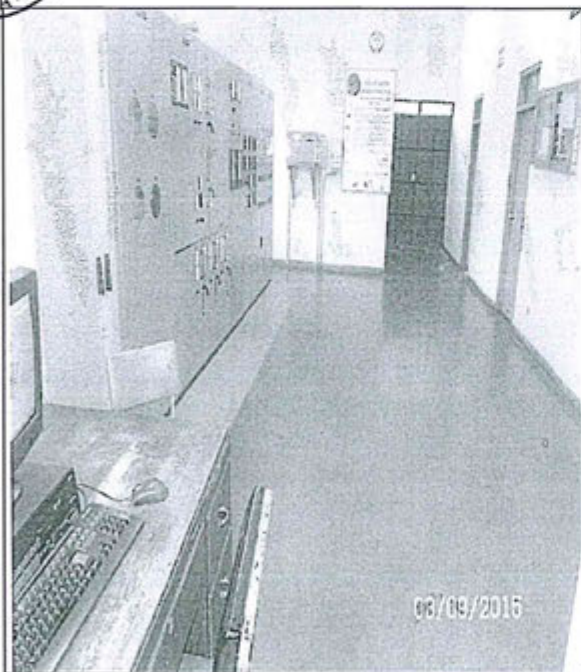
CENTRO DE LA SALA DE CONTROL – SET ILAVE
